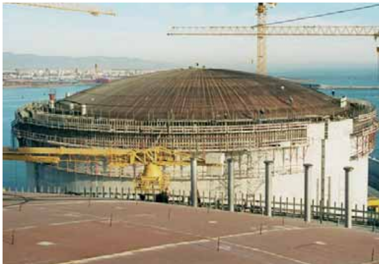
LNG Tanks, Sagunto, Spain
